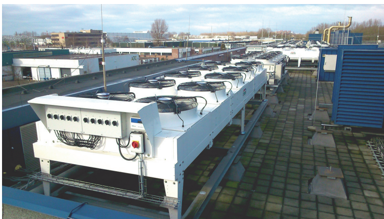
Afb. 10.7 Luchtgekoelde condensor met afgifte aan de buitenlucht
