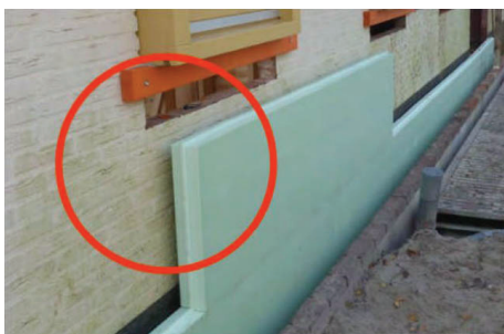
Afb. I.9 Isolatiemateriaal sluit niet goed aan op het binnenblad van de gevel (bron: Nieman)
