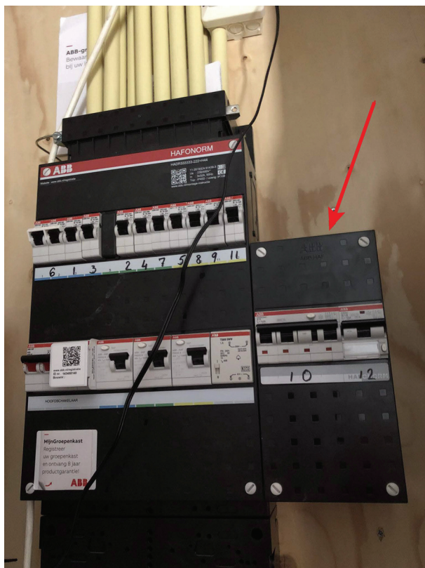
Afb. 15.1 Extra groepen in meterkast voor het PV-systeem
