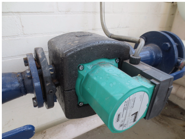
Afb. 10.10 Isolatie van leidingen en een geïsoleerde pomp
