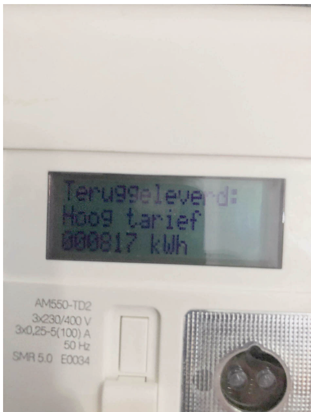
Afb. 15.2 Teruglevering van zonnestroom aan het elektriciteitsnetwerk
