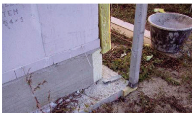
Afb. I.4 Isolatiemateriaal sluit niet goed aan op de omliggende constructies
