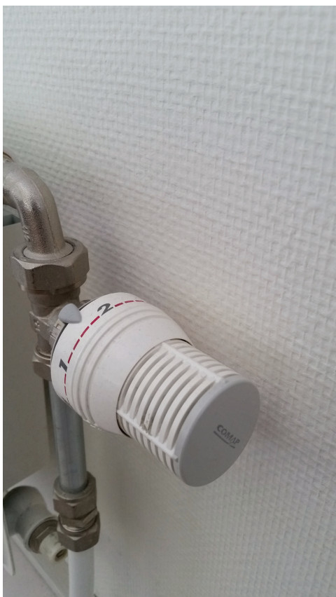
Afb. B.24 Radiatorthermostaat
