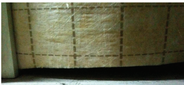
Afb. I.5 Isolatiemateriaal sluit niet goed aan op de vloer (bron: Nieman)
