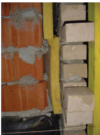
Afb. I.7 Isolatiemateriaal sluit niet goed op elkaar aan
