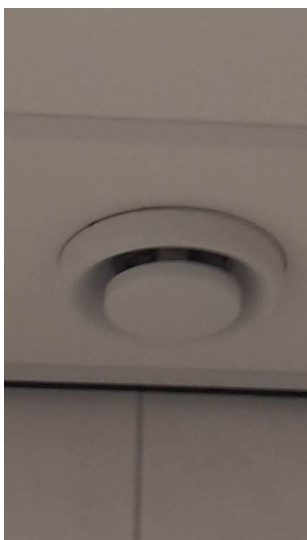
Afb. 11.7 Een afzuigventiel van mechanische ventilatie
