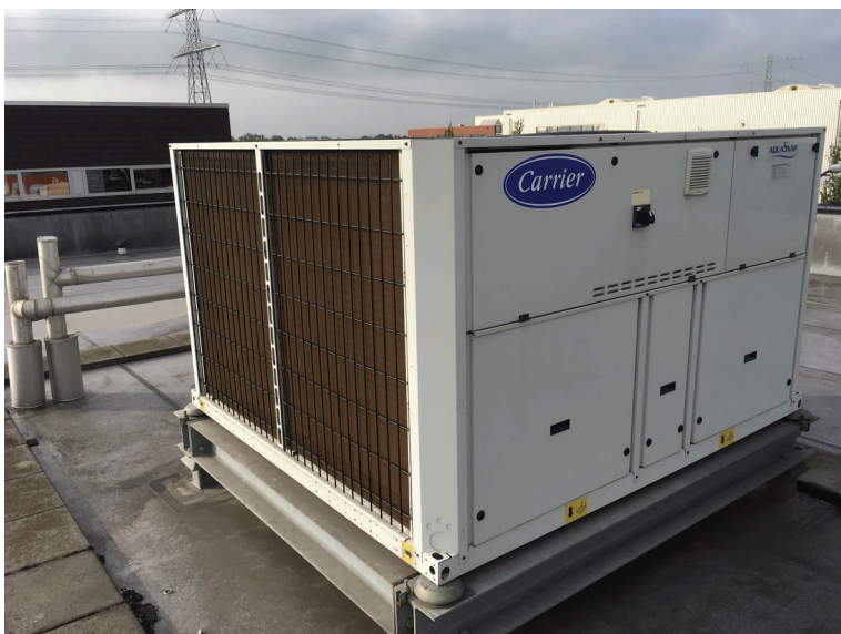
Afb. 10.6 Compressiekoelmachine met distributieleidingen
