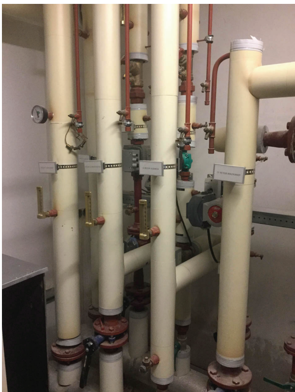
Afb. 13.4 Retourleiding van een indirect verwarmde boiler in het verdeelstation van de centrale verwarming
