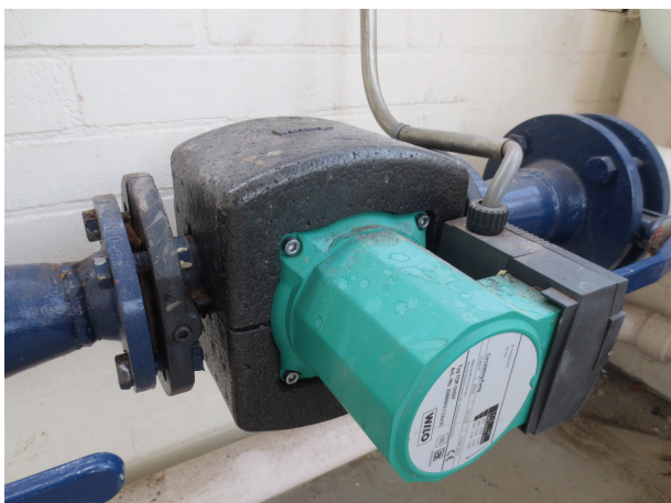
Afb. 13.9 Geïsoleerde circulatiepomp, op de voorkant staat het vermogen vermeld (bron: Wilo)
