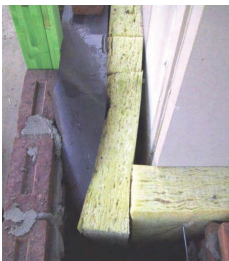
Afb. I.6 Isolatiematerialen sluiten niet goed aan, hierdoor ontstaat een open hoek. (bron: Nieman)
