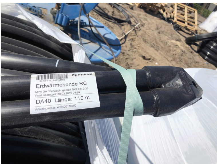
Afb. B.17 Leidingen van verticale bodemwarmtewisselaars
