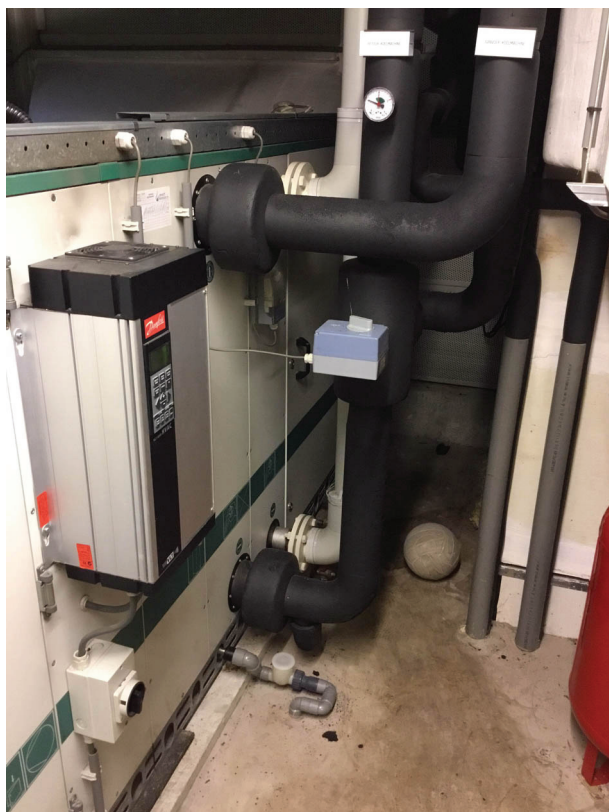
Afb. 11.12 Aansluiting van koelleidingen op de luchtbehandelingskast
