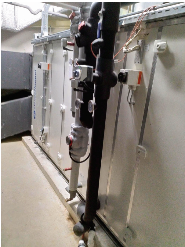
Afb. 11.13 Aansluiting van verwarmings- en koelleidingen op de luchtbehandelingskast
