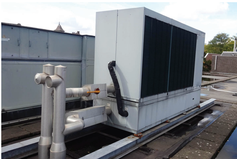
Afb. 10.5 Compressiekoelmachine met distributieleidingen
