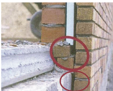
Afb. I.3 Isolatiemateriaal is niet goed doorgezet waardoor er een koudebrug ontstaat (bron: Nieman)
