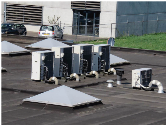
Afb. 10.3 Buitenunit van een splitsysteem op een dak (condensor)
