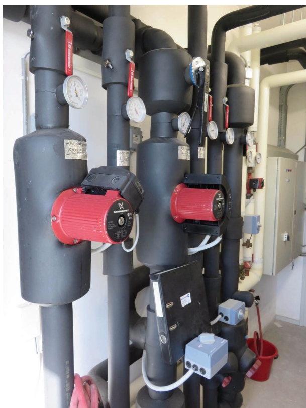
Afb. 10.11 Verdeelstation van koelinstallatie met geïsoleerde leidingen en appendages
