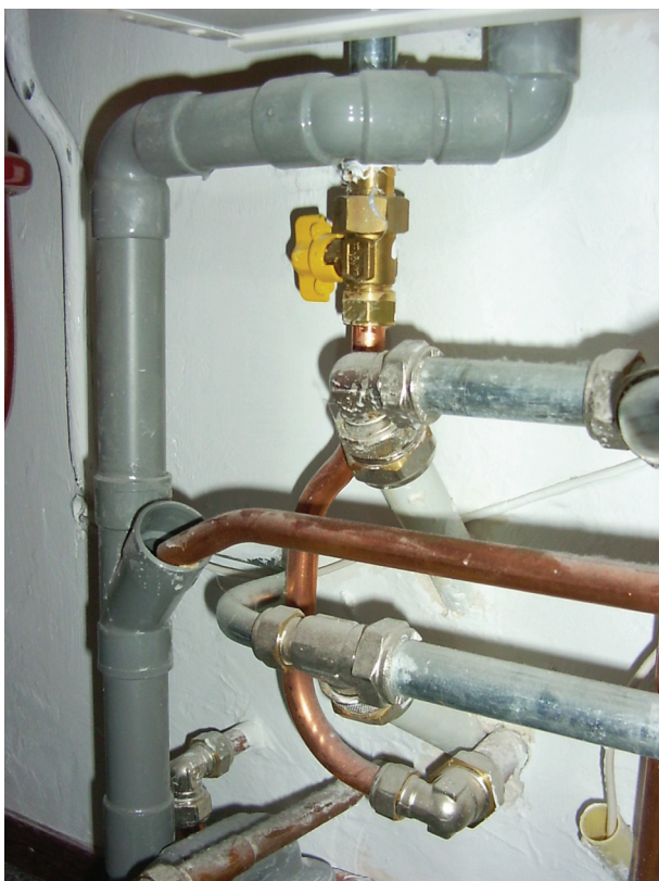
Afb. B.10 Condensafvoer onder CV-ketel, kenmerkend voor HR-ketels
