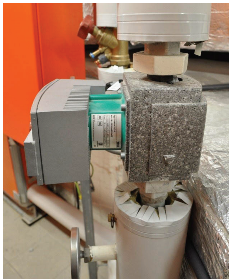
Afb. 13.7 Isolatie van leidingen en een pomp
