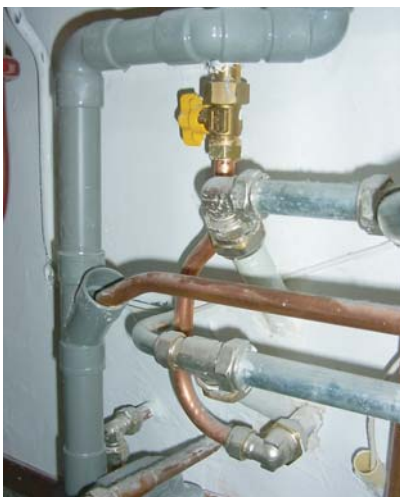
Afb. 3.15 Afvoerpijpje onder de CV-ketel, kenmerkend voor HR
