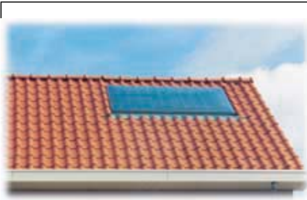
Afb. 3.31 Vlakke zonnecollector of zonnepaneel ingewerkt in een dak
