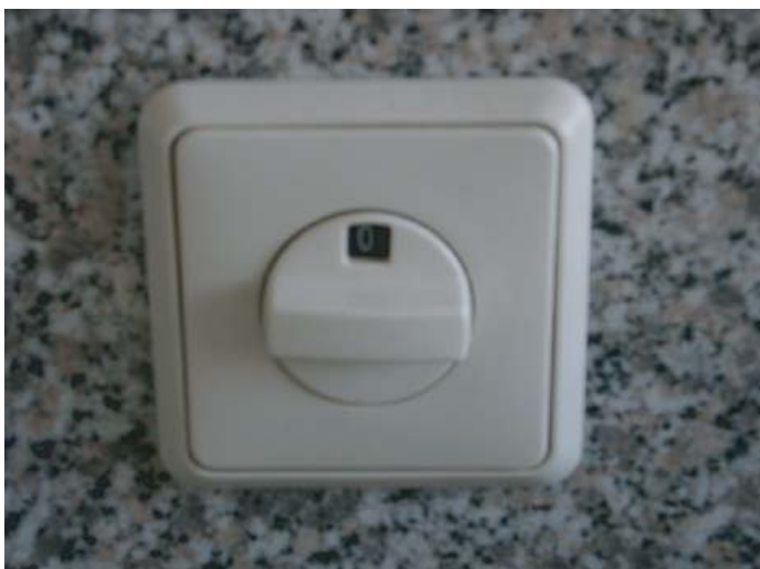
Afb. 3.45 Schakelaar voor mechanische ventilatie in keuken
